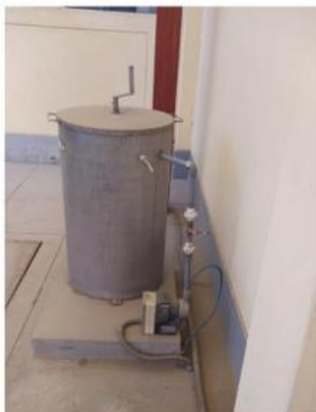
Fig. 3: Tanque de preparación de insumo químico
