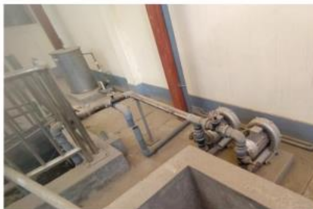
Fig. 5: Sopladores y conexión con poza de agua residual
