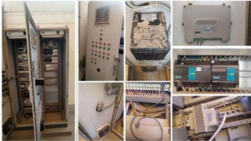
Fig. 8: Estado de componentes externos e internos del tablero eléctrico. Se observa acumulación gruesa de polvo externo e interno. Posible presencia de humedad en circuitos internos de equipos.
