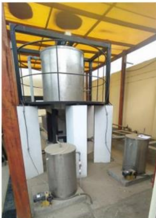
Fig. 2: Tanque de procesamiento principal de la PTAR
